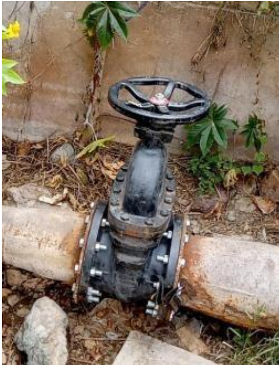
Ubicar Infraestructura en campo
